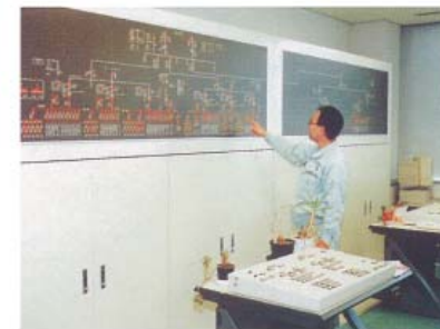
受電システム監視盤
