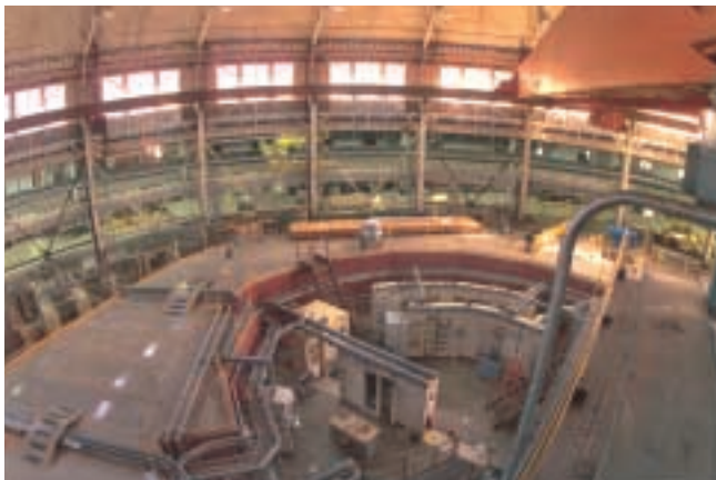
ALSの蓄積リング内部
