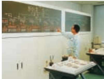
受電システム監視盤
