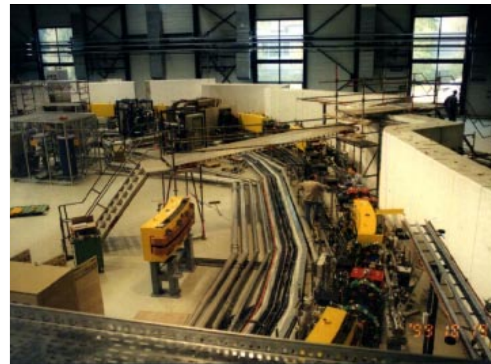
建設中のANKA (Angstrom Karlsruhe) 蓄積リング (ドイツ カールスルーエ)
